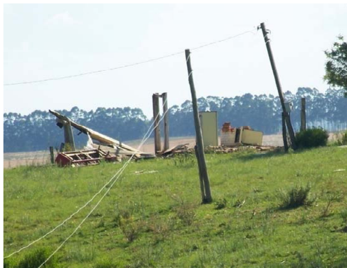
FOTO 6 – Casa semidestruída de um local recém comprado. Esta visão lúgubre não é rara, fazendo supor que este semianiquilamento ocorra para tornar o local perigoso, o que impediria que qualquer pessoa pudesse utilizá-lo como moradia.
